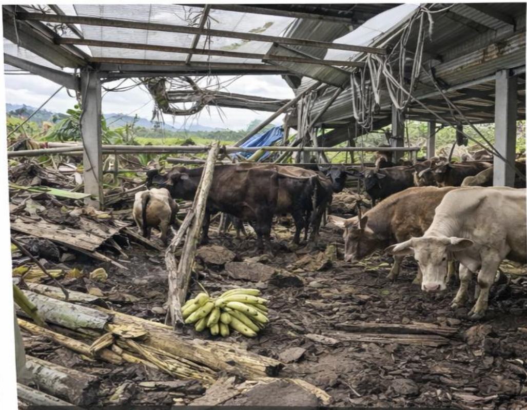
Bâtiment d'élevage détruit par un cyclone
