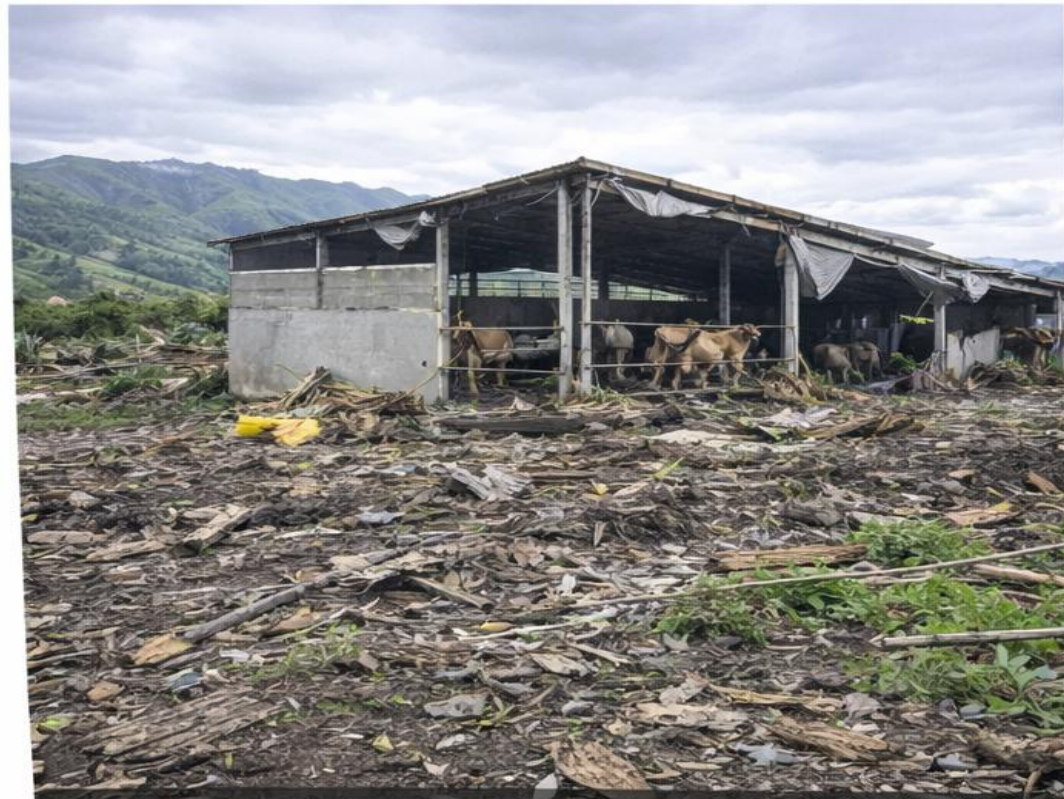
Bâtiment d'élevage endommagé par un cyclone
